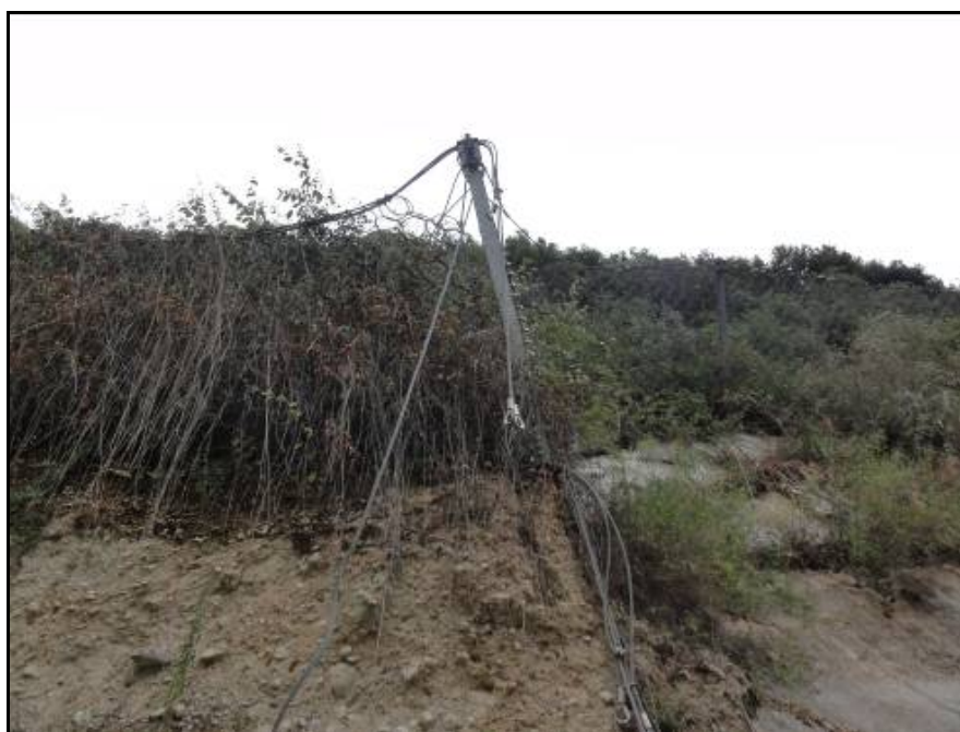
Fig. 18 – Particolare del pilone della barriera non tirantato che ha provocato l'afflosciamento della rete.
